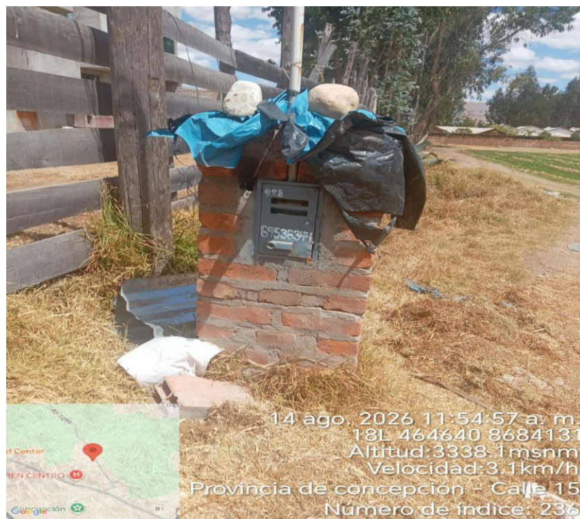
Imagen N° 31– Calle 15 (vista de suministro eléctrico)
