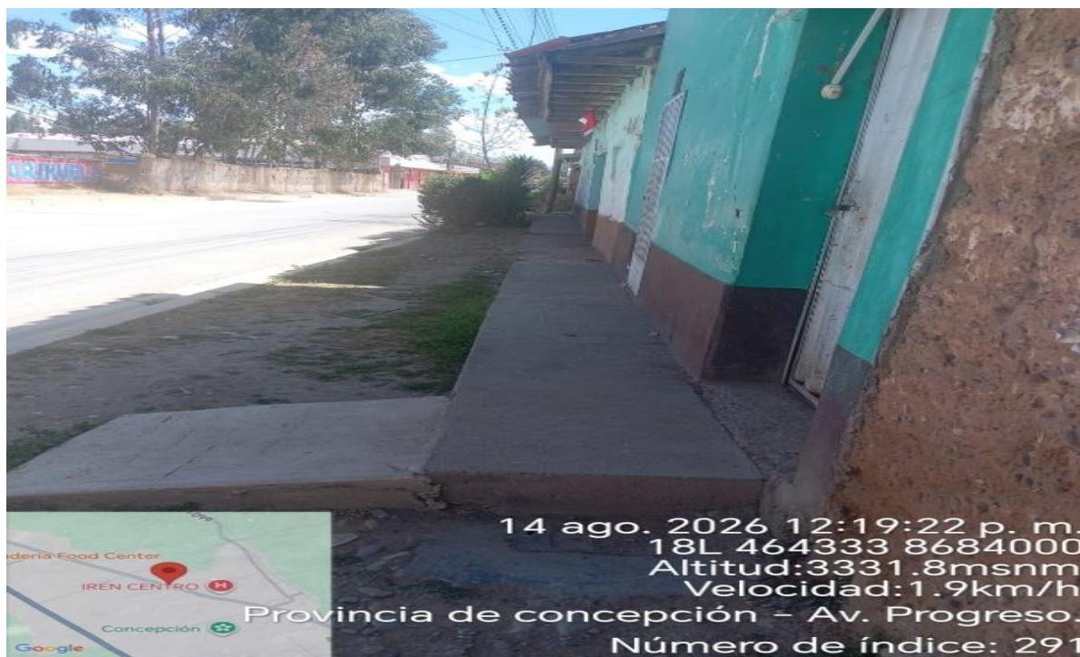
Imagen N° 11– Av. Progreso (vista de servicio de agua potable y alcantarillado)
