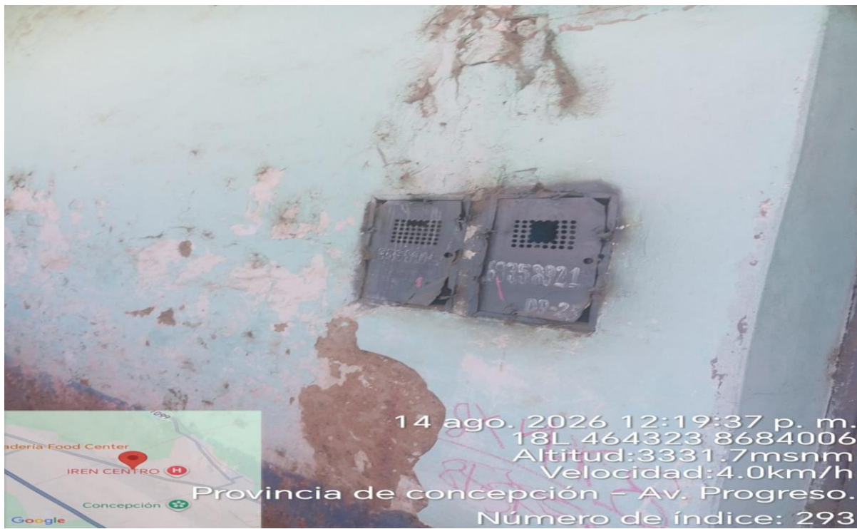
Imagen N° 09- Av. Progreso (vista de suministros de energía eléctrica)
